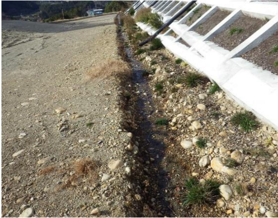
湧水状況(起点側)
