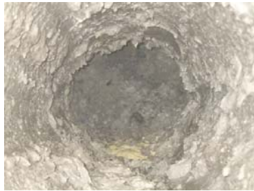
先端部分（崩れあり）
