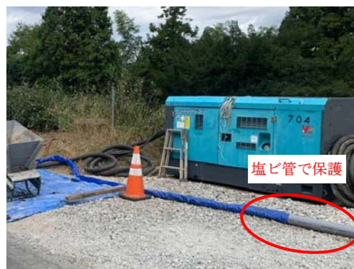
ホース接続部 塩ビ管で保護
