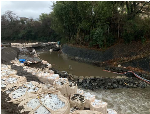
写真-7 出水時の水が施工箇所流入
