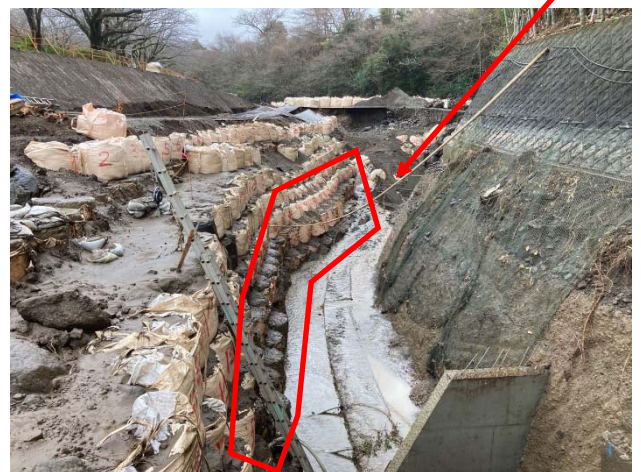
写真-8 流入した水の排水後
