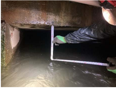
水位桁下 350 施工不可
