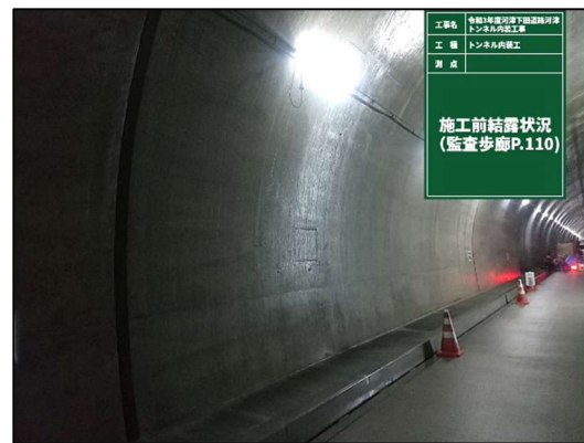
写真-4 結露状況(8月結露あり)
