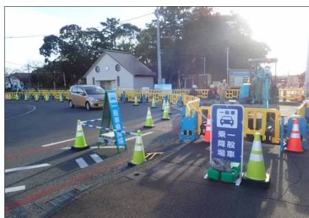
《安全柵設置状況》
