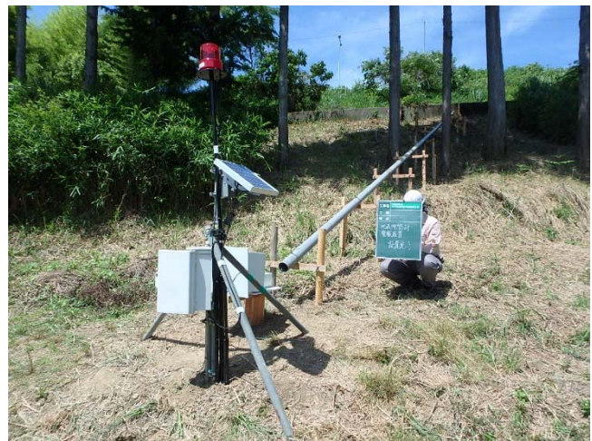
伸縮計警報装置設置状況
