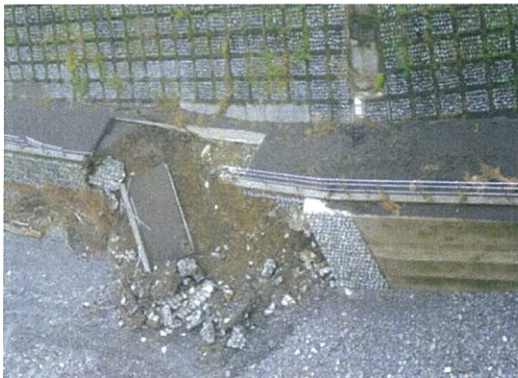
崩壊直後の状況
