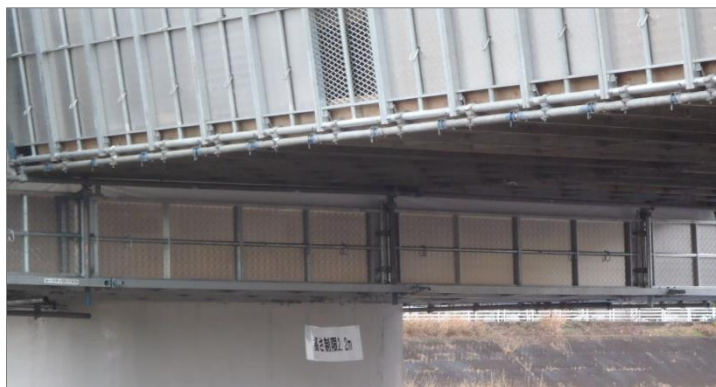
写真 7・橋脚周りの隙間がない状態（足場の外部から撮影）
