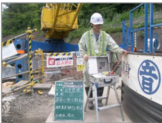
複合型ガス検知器常設
