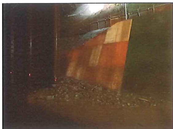
土砂流出状況
