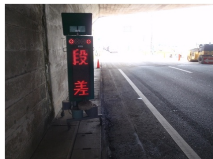
電光板設置状況
