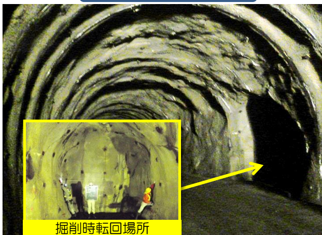
支保工未設置区間
