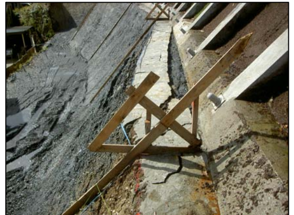
2号法枠区間 崩落状況
