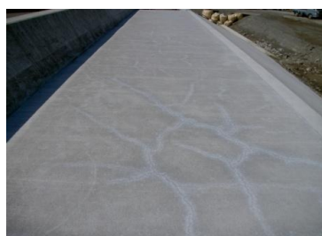
クラック発生状況
