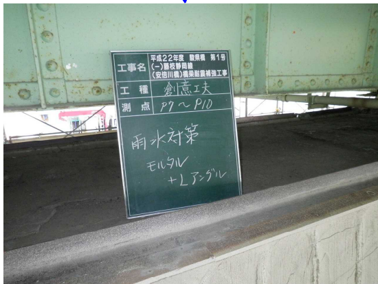
雨水進入対策状況
