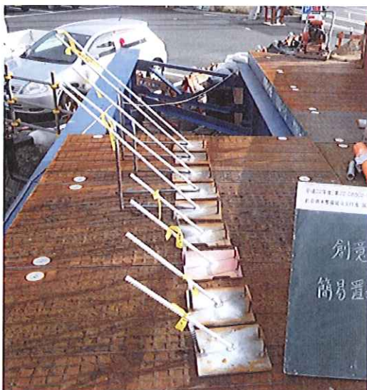
簡易置き型丁張り 撤去しやすい抵抗の少ない鉄筋を使用 夜間に目立つよう白色とする
