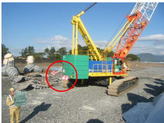
120tクレーンの本体部の全景(後部より)
